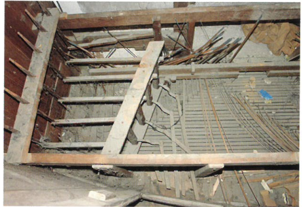
Toestand onder de windladen bij demontage, stofvervuiling en slordig aangelegde registermechanieken
